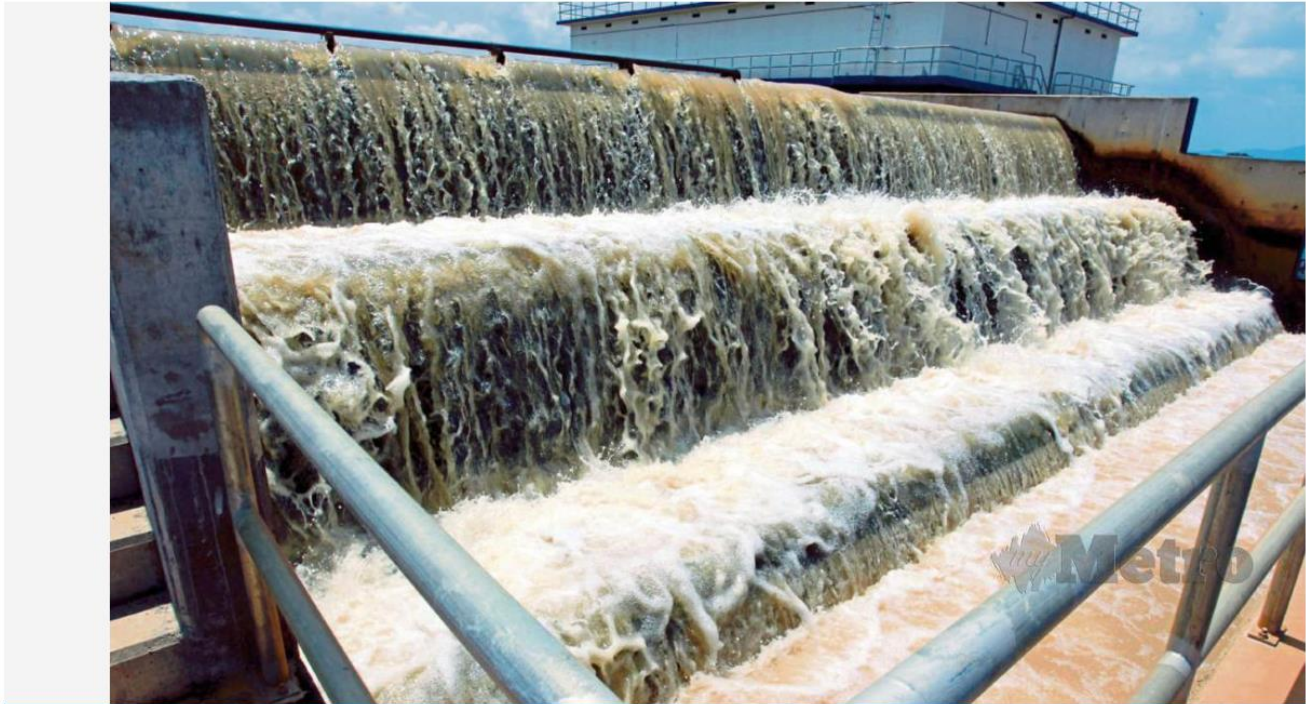
LOJI Rawatan Air (LRA) Panching. FOTO Arkib NSTP
